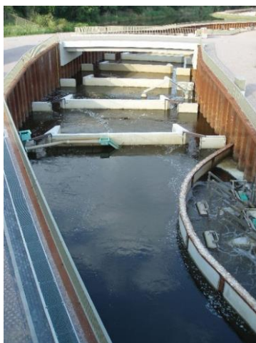
Rysunek 5 Szczelinowa przepławka na Łabie w Geesthacht (widok na komory i szczeliny).
